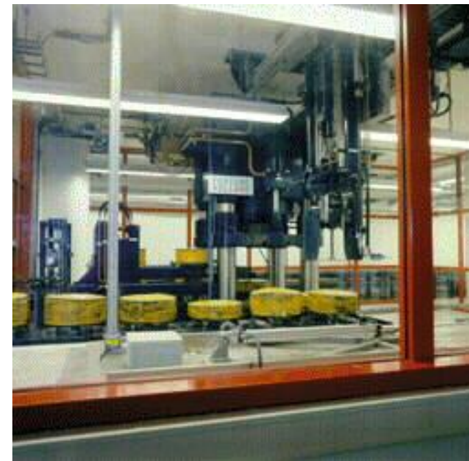
"pizze" da fusti supercompattati (impianto COVRA, Olanda)
